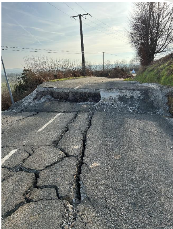
Le glissement de terrain de la RD136 route de Nogent
